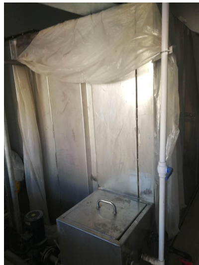
废气处理装置
