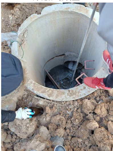
污水处理站出水口
