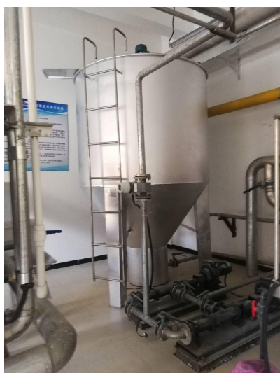
污泥浓缩装置
