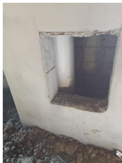
污水站排气筒
